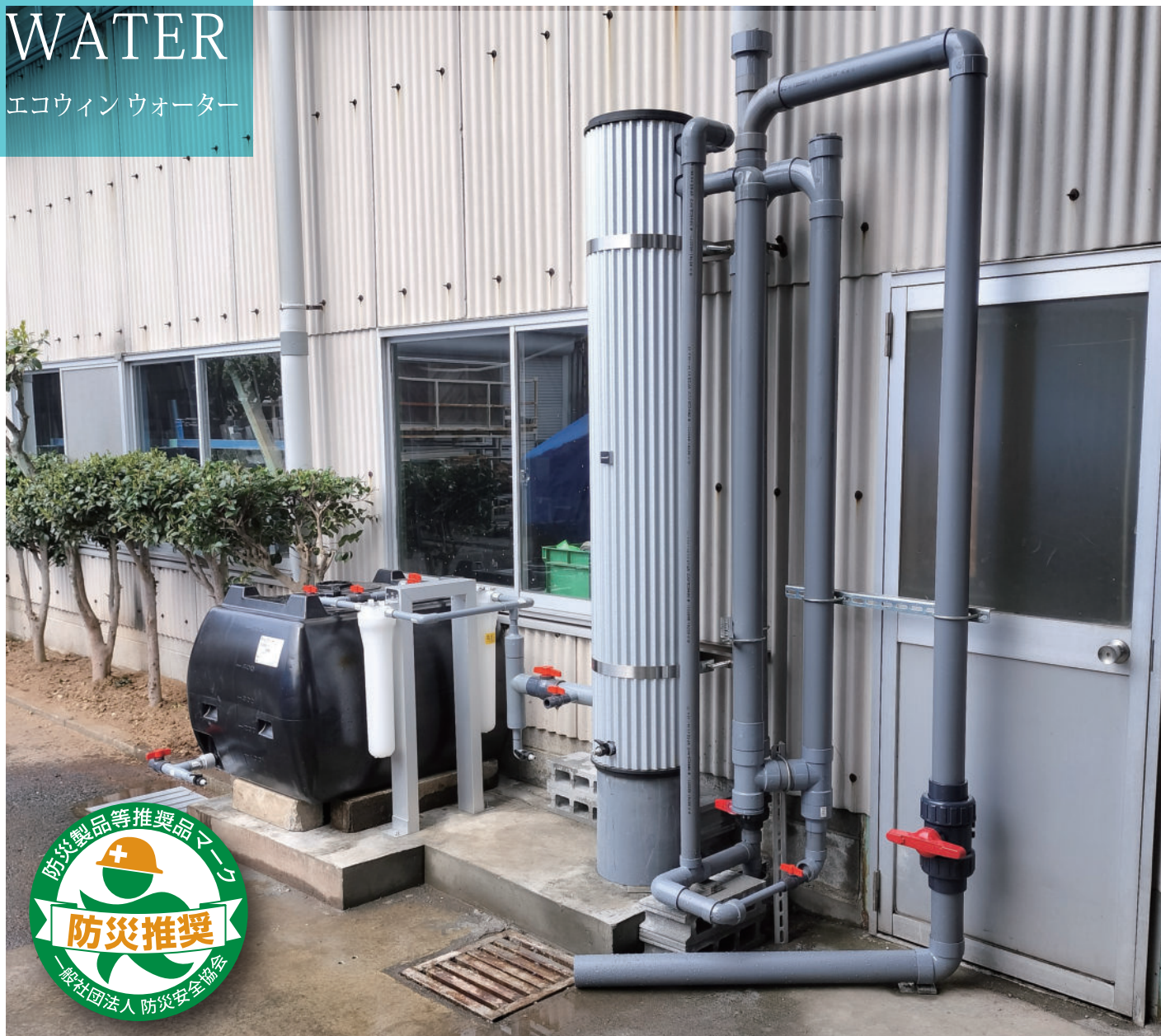
熊本県 金属加工工場 設置事例
