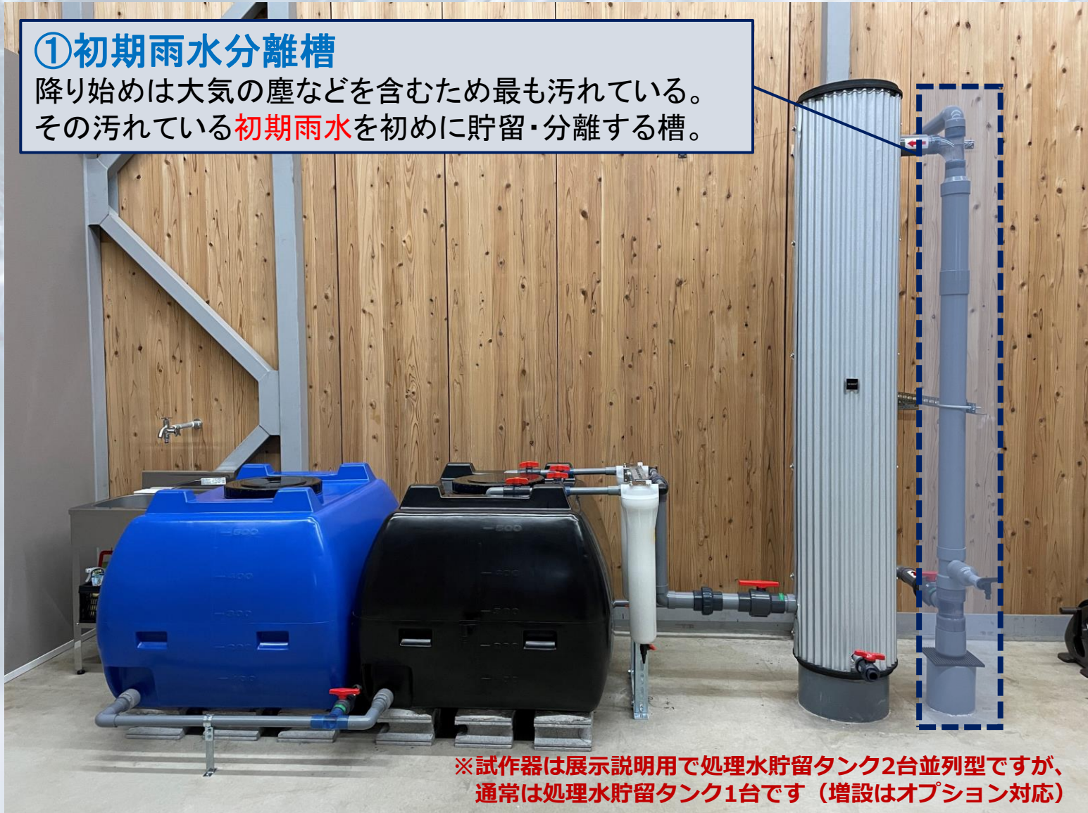
試作器全体写真（SDGsLABO倉庫内に設置）
