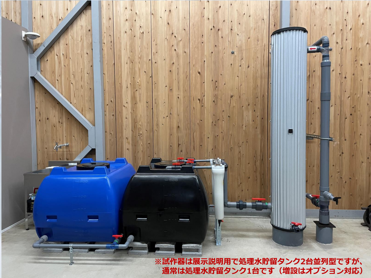
試作器全体写真(SDGsLABO倉庫内に設置)
