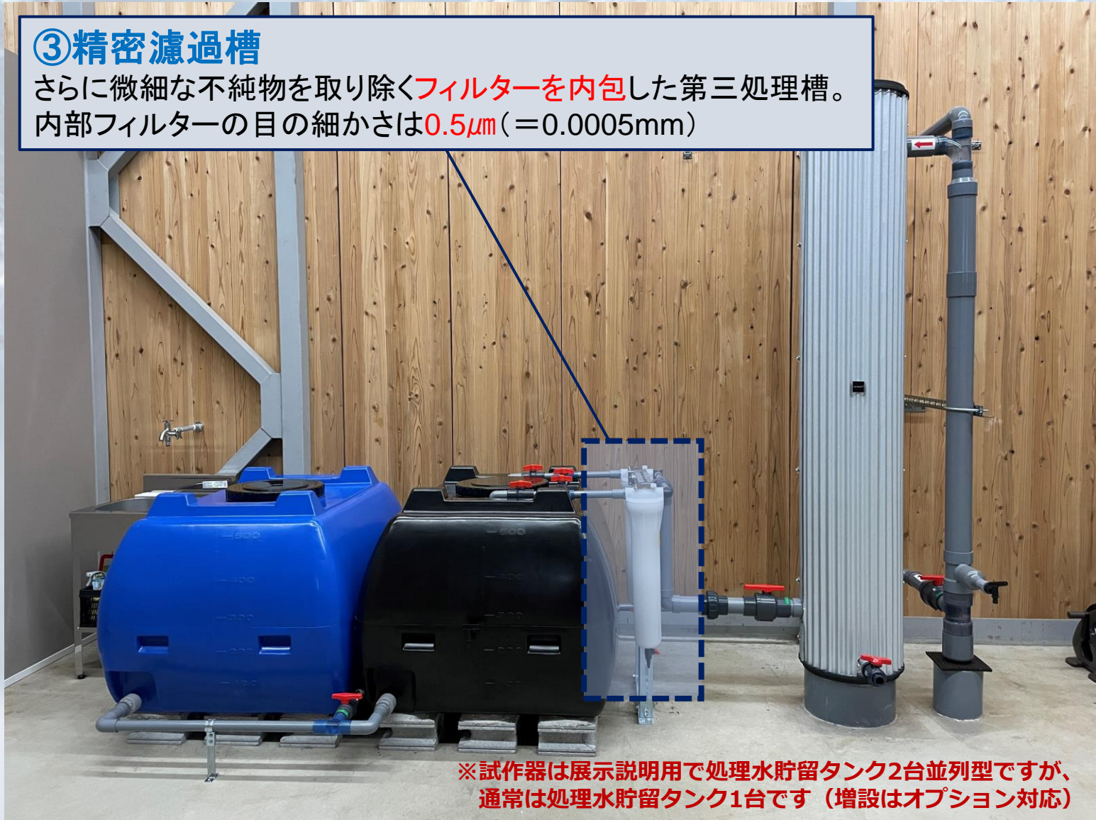
試作器全体写真(SDGsLABO倉庫内に設置)
