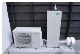
ヒートポンプユニット
