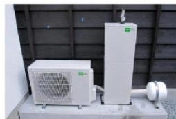
ヒートポンプユニット
