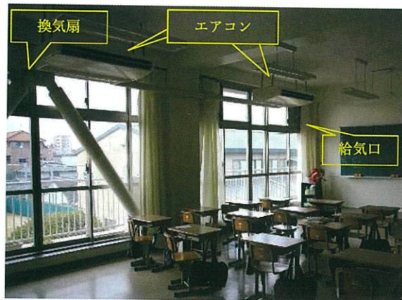
写真1 対象室の機器設置状況
