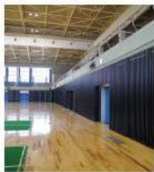
大きな体育館も空調に放射冷暖房を使っている
