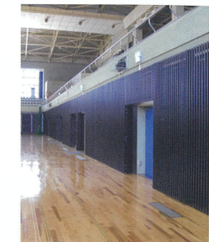
写真2 体育館での使用例(宇土市民体育館)
